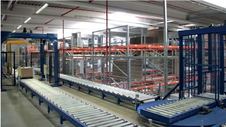
Vollautomatische Paletten-Förderanlage Fully automatic pallet conveyor installation
